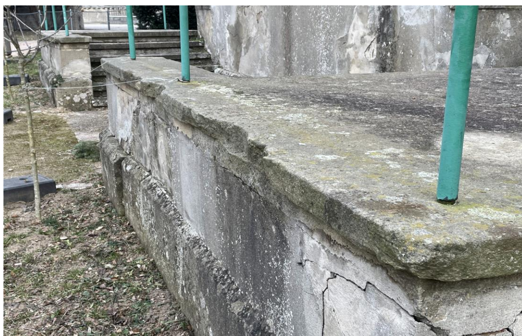
Detaily mechanických defektů na nárožích přístupových schodišť na terasu západního průčelí
