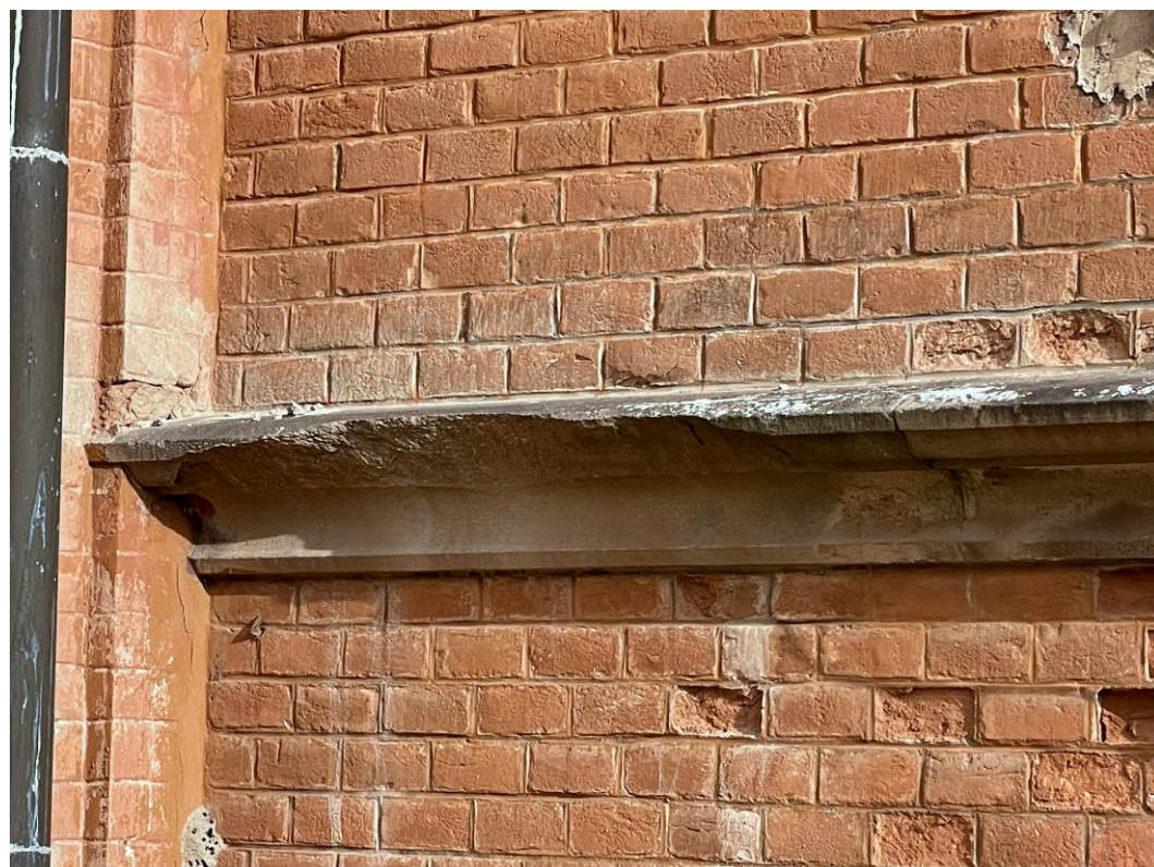
Detaily poškození lícového zdiva a kamenných prvků rizalitu východního průčelí zámku
