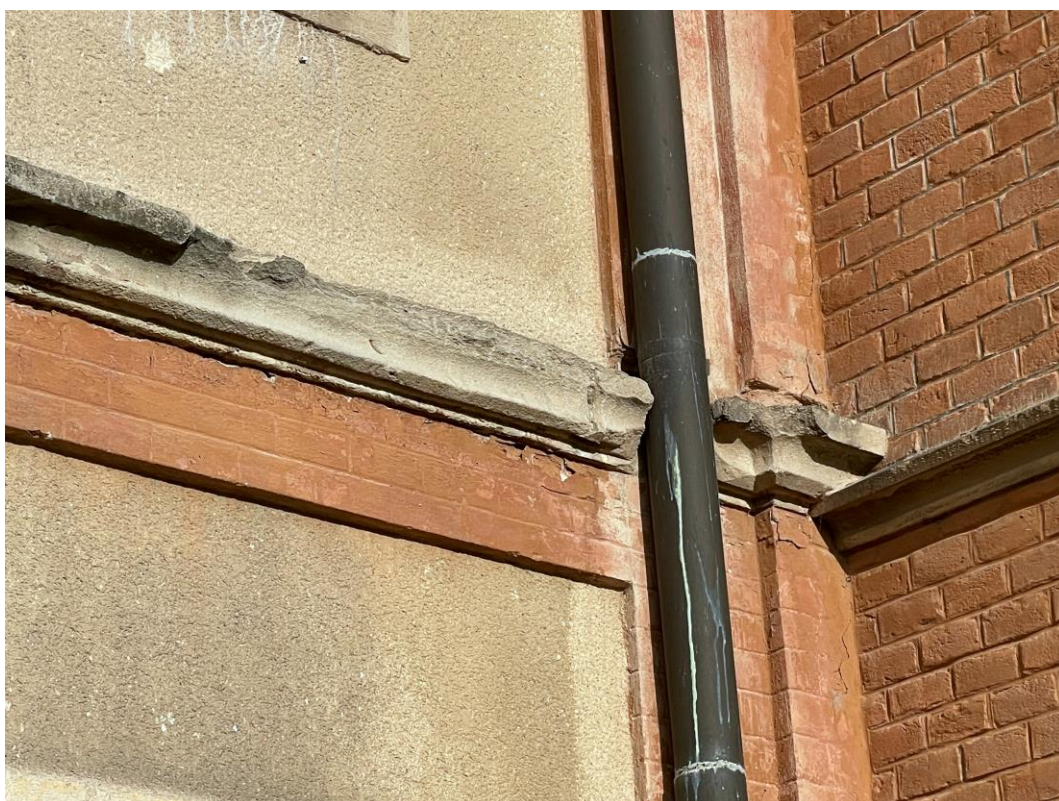
Detaily poškození kordonových říms V/14,26 východního průčelí zámku
