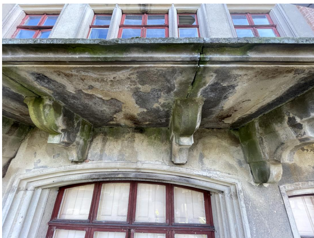
Detaily balkonu Z/24 rizalitu západního průčelí - havarijní stav balkonové desky i konzol
