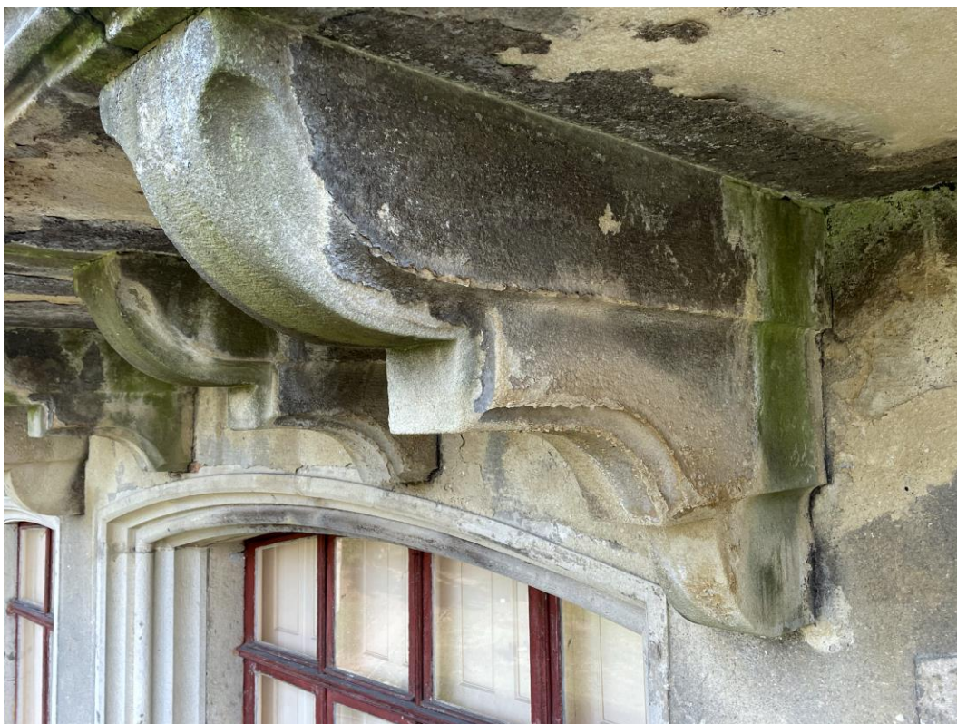
Detaily balkonu Z/24 rizalitu západního průčelí - havarijní stav balkonové desky i konzol
