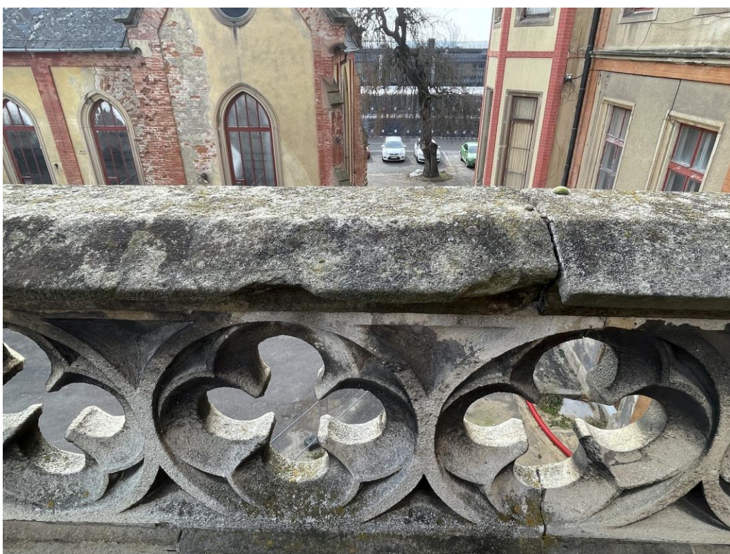
Detaily kružbové výplně balustrády V/48 terasy nad síní východního průčelí a její poškození
