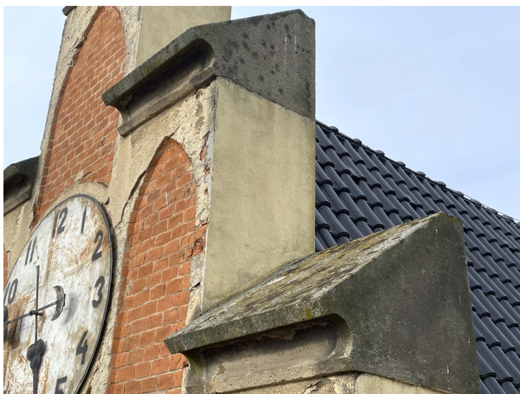
Detaily kamenných desek V/1 ve štítu východního průčelí
