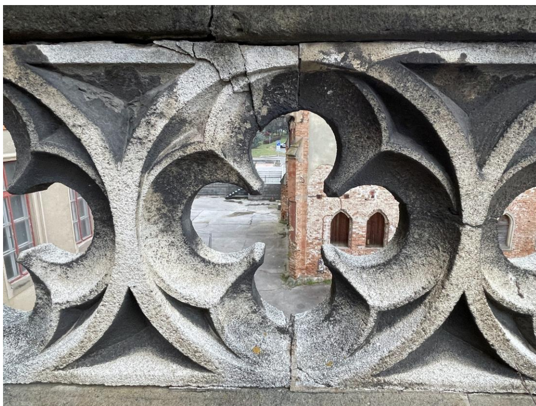
Detaily kružbové výplně balustrády V/65 terasy nad síní východního průčelí a její poškození
