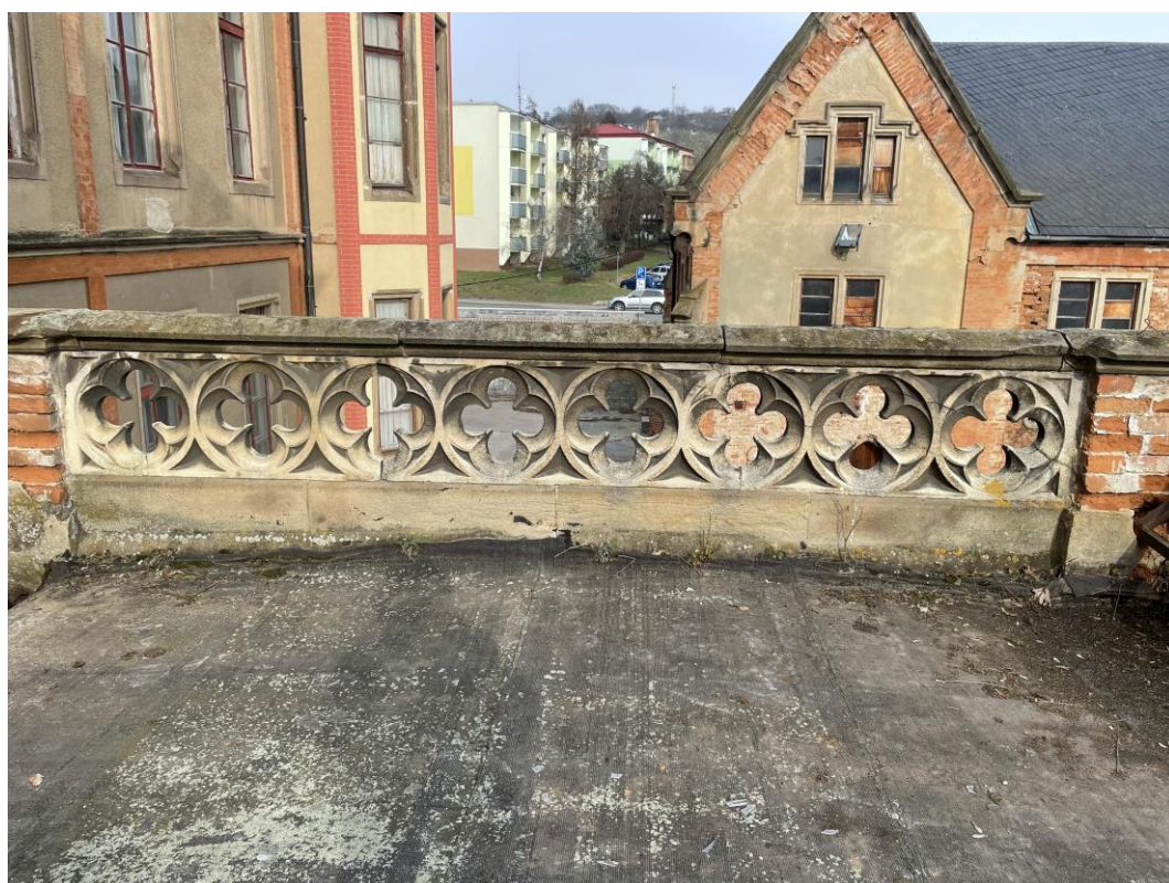
Detaily kružbových výplní balustrády V/58,65 terasy nad síní východního průčelí a její poškození
