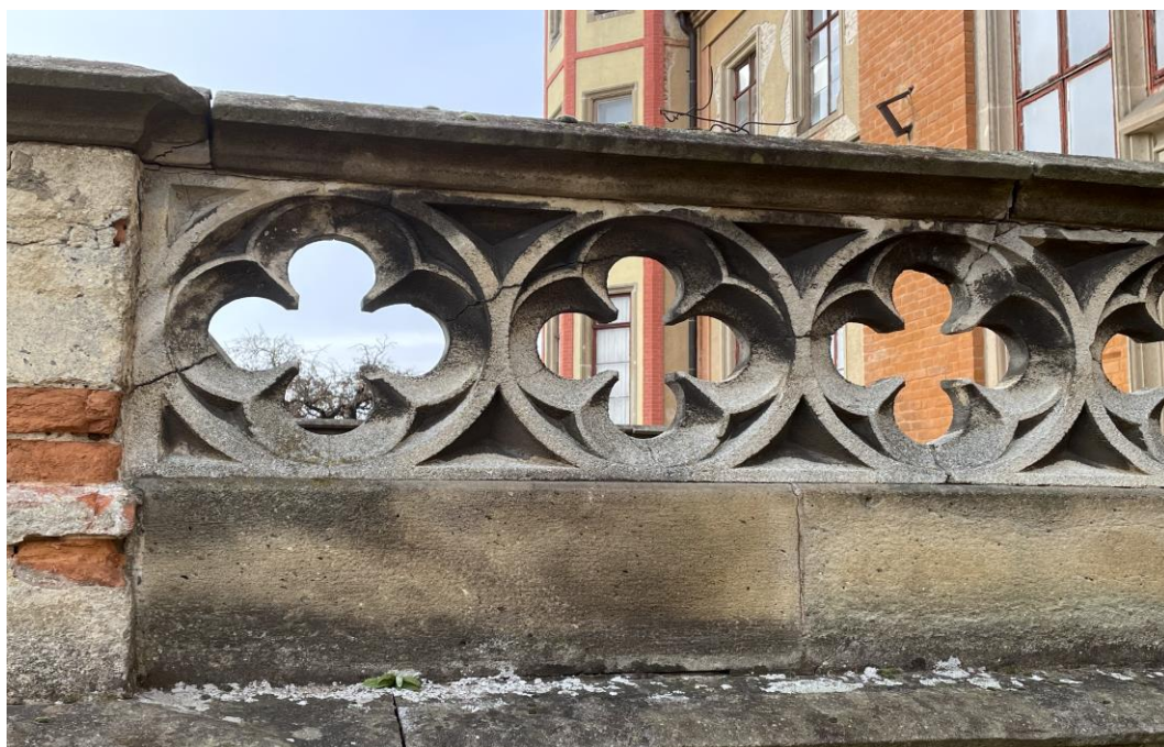
Detaily kružbové výplně balustrády V/48 terasy nad síní východního průčelí a její poškození
