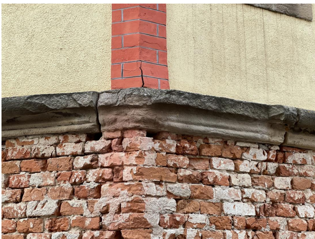
Mechanické defekty na nárožích římsového soklu JV/21
